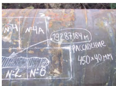
Магистральный газопровод DN 1200 ОАО «Газпромтрансгаз Беларусь»
