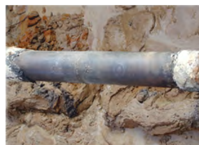
Газопровод-отвод (DN 200) (ОАО «Газпромтрансгаз Беларусь»)
