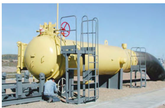
Камера запуска очистных и диагностических устройств DN 1400 ЛЧ МГ (ОАО «Газпромтрансгаз Беларусь»)
